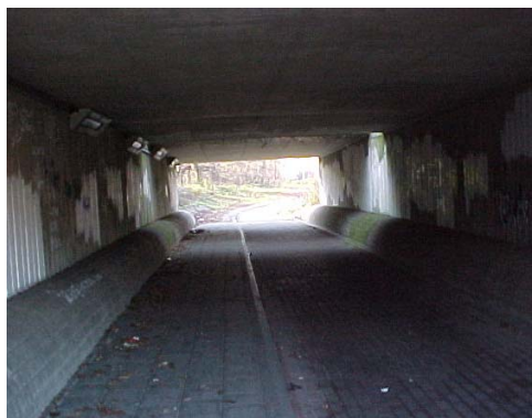
Foto 5.83 Verlichting van tunnels middels dooronderbrekingen in het tunneldak
